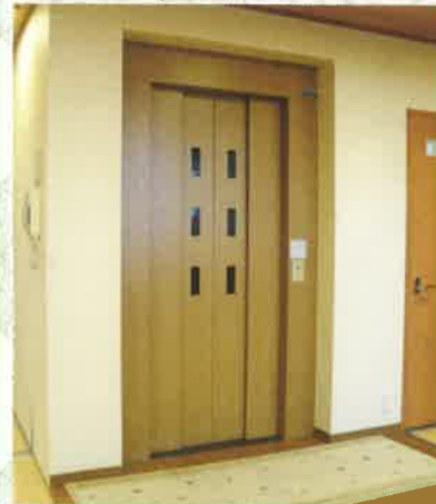
エレベーター
